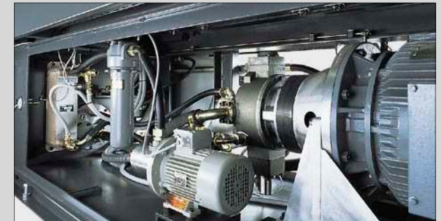
Direkter Zugang zur hydraulischen Pump- und Filteranlage
